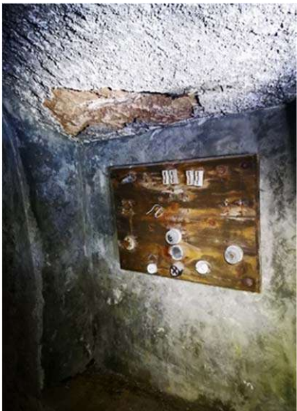
Antic quadre de llums i fusibles del refugi.2019
