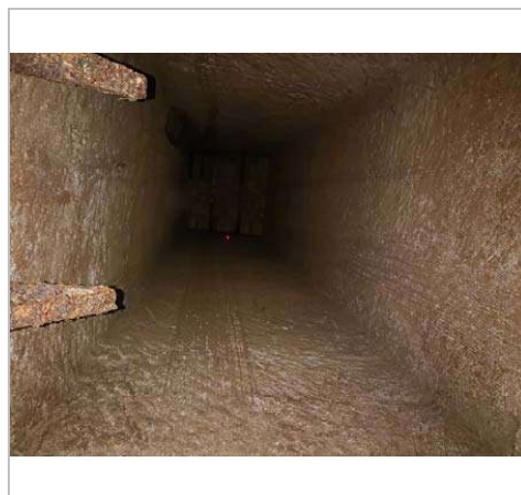
Pou Ventilació 2019 Estudi d'Arq. Pujol
