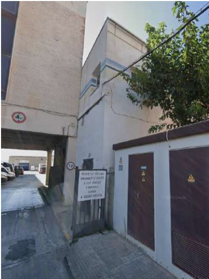
Centre de transformació – Edifici 13
