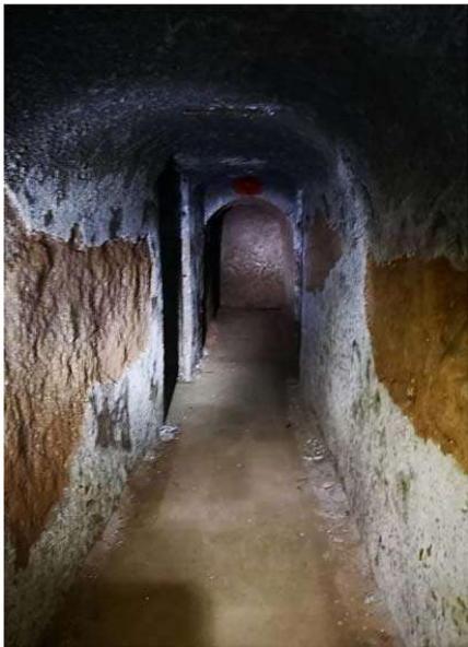
Galeria central patologies en revestiments. 2019
