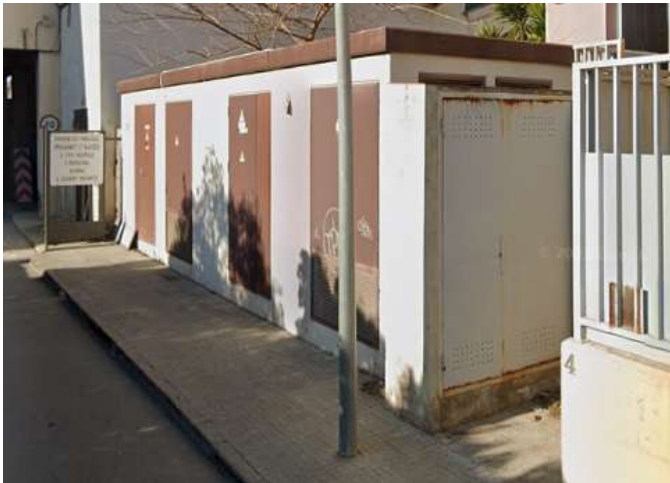
Centre de transformació – Accés recinte Plàsmica
